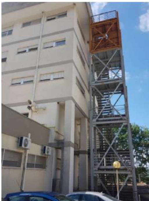
Vista scala esterna in acciaio in cui si osserva il forte fenomeno di corrosione dell'ultimo livello
